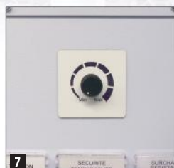
7 Fan speed controller
